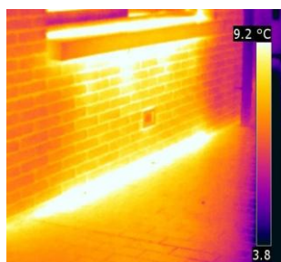
Particolare dispersione radiatore in nicchia
