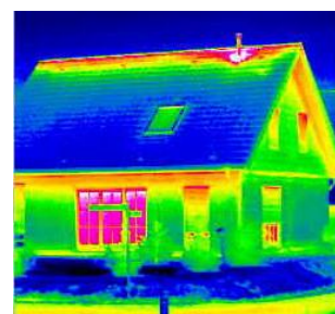
Dispersioni dal tetto
