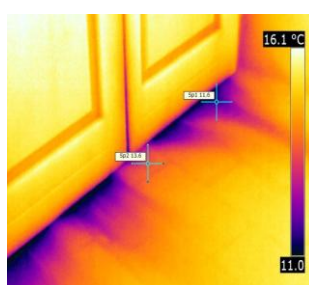
Infiltrazione d'aria dalla porta d'ingresso
