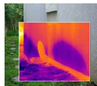
Risalita umidità dal terreno
