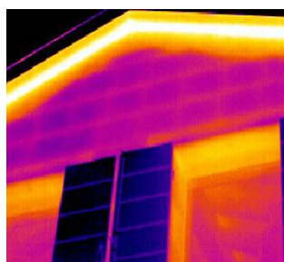
Ponte termico tetto
